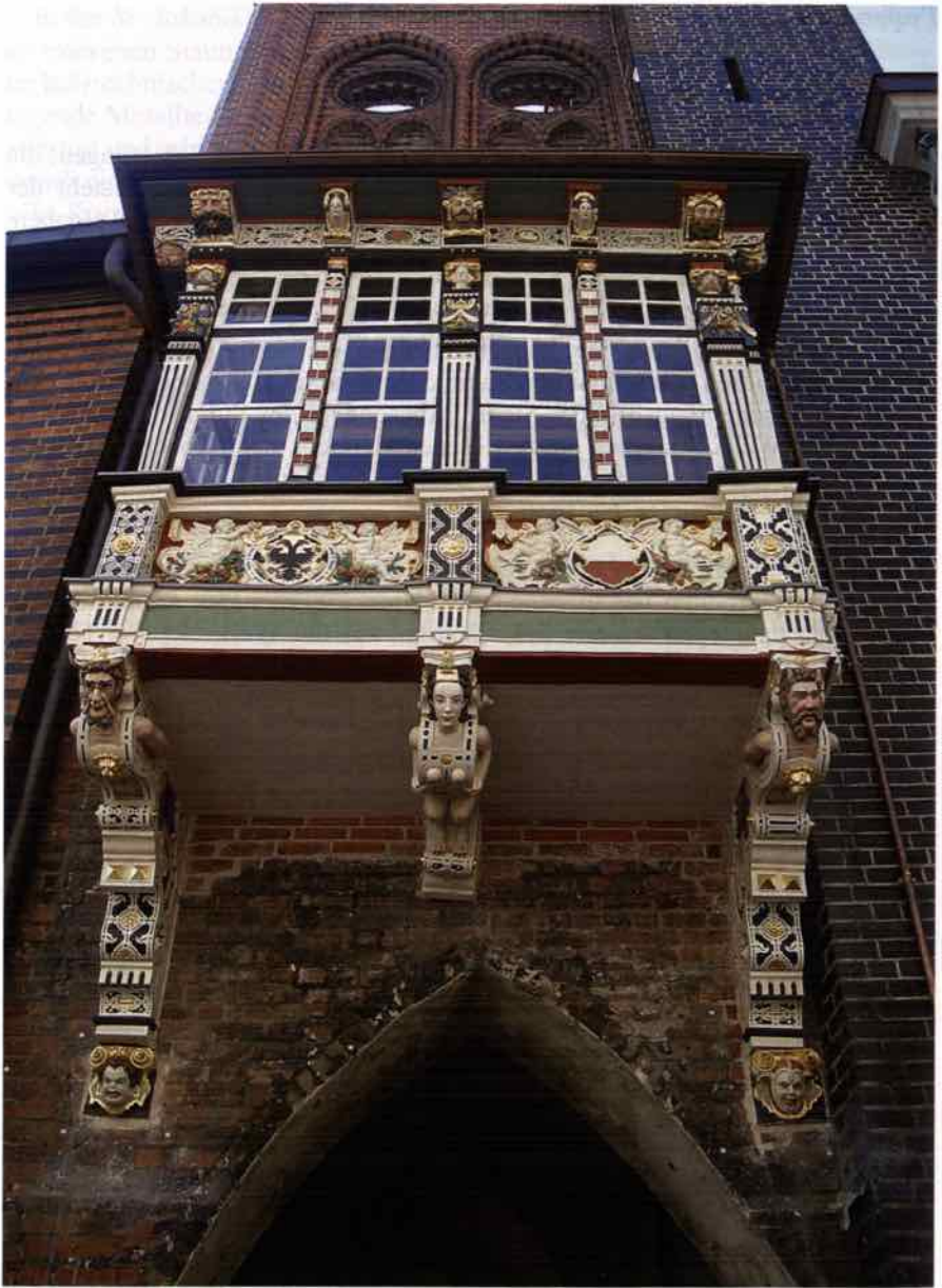
Abb. 7: Rathaus, Renaissance-Erker, Ansicht nach statischer Sicherung und farbiger Restaurierung
