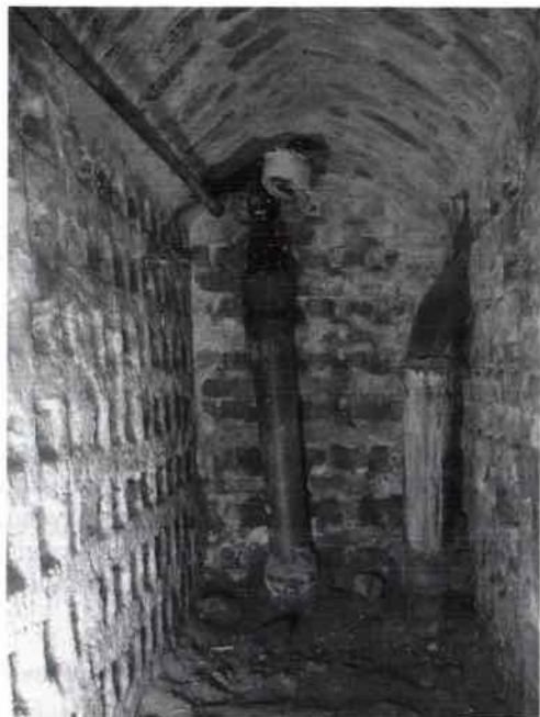
Abb. 8: Königstraße 2. „Gang“ vom Keller des Nachbargebäudes am Jacobikirchhof unter das EG von Königstraße 2 (vermutlich 19. Jahrhundert).
