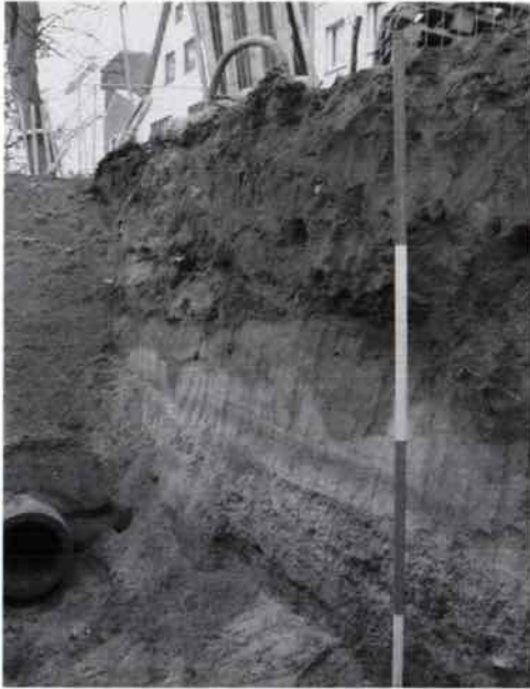
Abb. 17: Travemünde. Blick in die Kanaltrasse unter der Torstraße: Zuunterst Sedimente und anthropogene Schichten im Wechsel, im oberen Drittel überlagert von neuzeitlichen Auffüllschichten.
