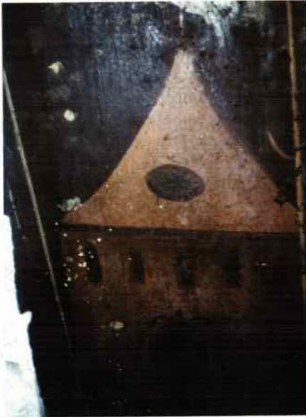
Abb. 5: An der Untertrave 6, Befund von Deckenmalerei
