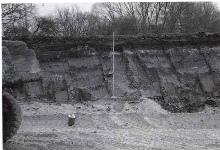
Abb. 7. Große Erdbewegungen werden beim Bau der Trasse für die A 20 vorgenommen - und darunter kommen Befunde und Funde aus dem Neolithikum und der Bronzezeit zum Vorschein.
