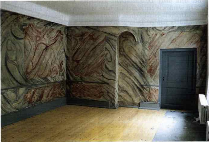
Abb. 10: St. Annen-Straße 4, stucco-lustro-Raum aus der 2. Hälfte des 18. Jh. im Seitenflügel nach Beendigung der Restaurierung (Ausschnitt)
