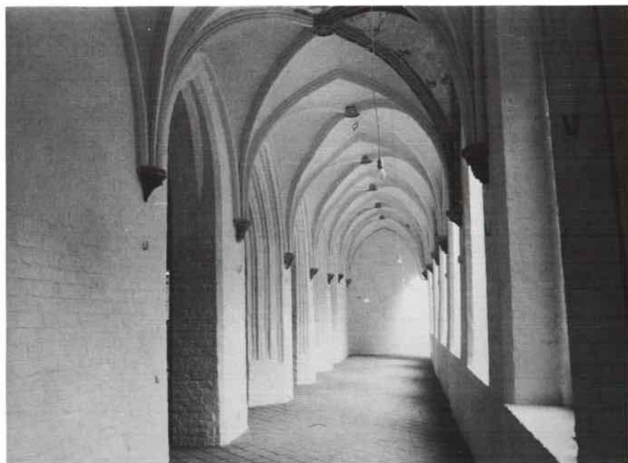
Abb. 13. Westlicher Kreuzgangflügel nach Norden mit den Portalöffnungen des Kapitelsaales. Im Vordergrund Probefreilegung am Gewölbe. 1989
