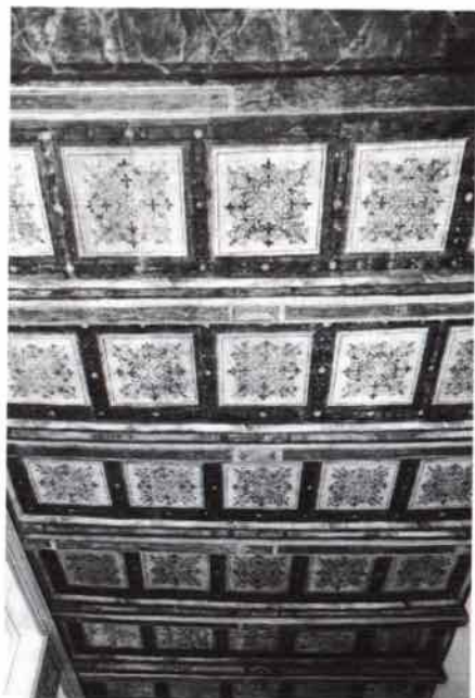
Abb. 36. Dr.-Julius-Leber-Straße 58. Decke im Erdgeschoß des Flügelbaus nach der Restaurierung
