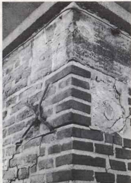
Abb. 4. Jakobikirche. Mauerschäden im obersten Turmgeschoß.
