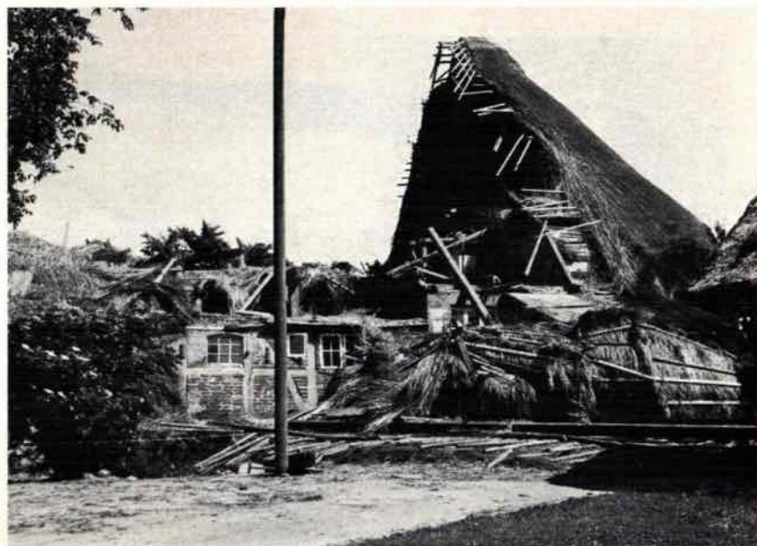
Abb. 7. Pöppendorf. Sturmschäden am Hof Dabs. Fotos: Amt für Denkmalpflege/Wilde
