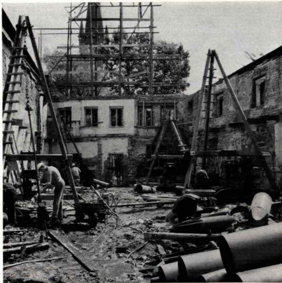
Salzspeicher VI. Arbeiten an der Bohrpfahlgründung im Inneren zur Gesamtsicherung der Bausubstanz. Aufnahme: Amt für Denkmalpflege, Peter Hein.
