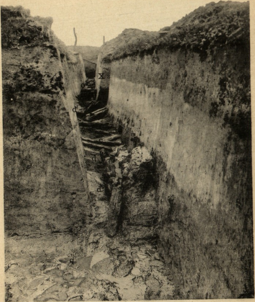
Blick auf das Ostende von Rundschnitt X: auf die äußere, die Südwand, mit der Öffnung von Teilschnitt X 3. Im westlichen Vordergrund die einzige Lücke der Holzpackung (q): die eigentümlichen flecke am Boden sind nur die Spuren der Stiefeln unserer Arbeiter im feuchten Erdreich. Auch hier die Holzpackung (c) mit den sie absteifenden Bohlen (d).
