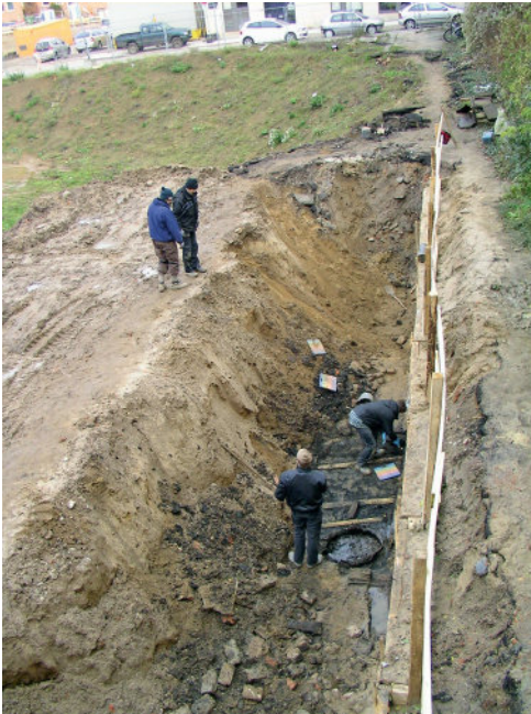
Abb. 11: Braunstraße 14, Hof. Reste hölzerner Baustrukturen des 12./13. Jahrhunderts (von S), welche erst beim Einbringen der Baugrubensicherung für das Baufeld „Gründungsviertel“ aufgedeckt wurden (z. Lage vgl. Abb. 3).
