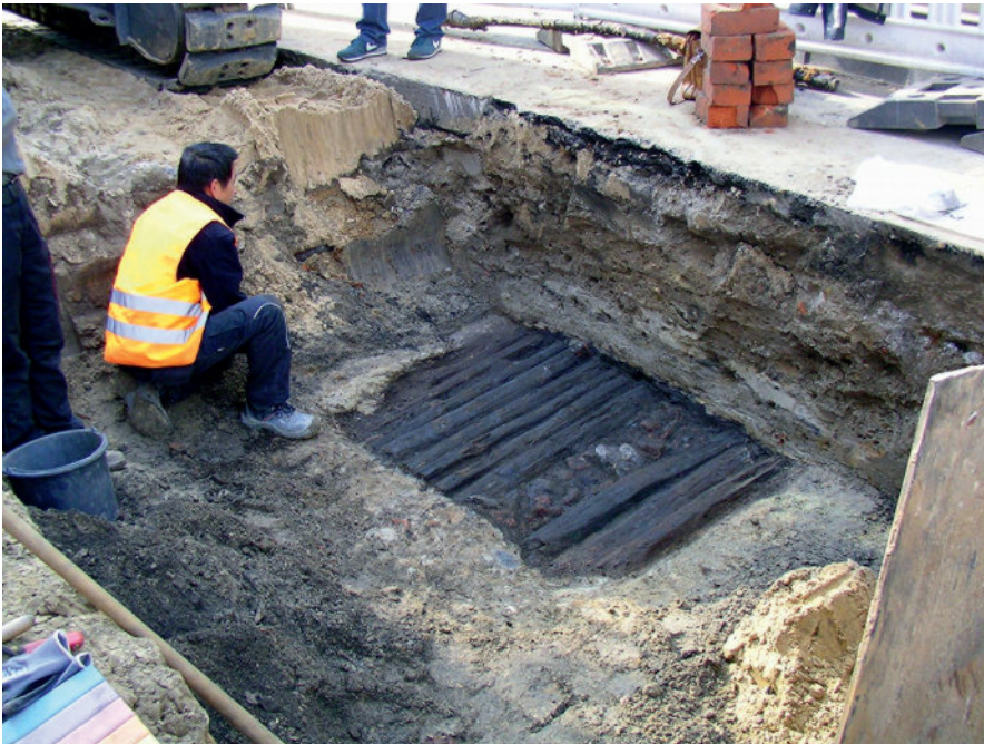
Abb. 34: Fegefeuer. Weniger als 1 m unter der heutigen Oberfläche stieß man auch hier mehrfach auf sehr gut erhaltene Abschnitte mittelalterlicher Holzstraßen. Der „Schotterstreifen“ dazwischen markiert in der Regel die Grenze zwischen zwei Anliegern (Jeder musste nur vor der eigenen Tür kehren). Die Breite des Belages reichte ursprünglich fast von Häuserfront zu Häuserfront.
