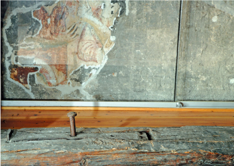
Abb. 10 Wandmalerei in der Kapelle des Hermann Wyldelove hinter Glas gesichert, davor auf dem Boden um 1797 eingebauter hölzerner Zuganker zur Sicherung mit eiserner Krampe und Nagel.
