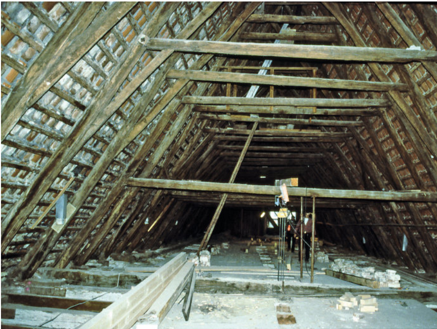
Abb. 12: Dach nach Westen mit zusätzlicher Kehlbalkenlage und Schwelle für Fachwerkgiebel nach Abnahme des westlichen und mittleren Teils des Obergeschosses im Jahr 1618.
