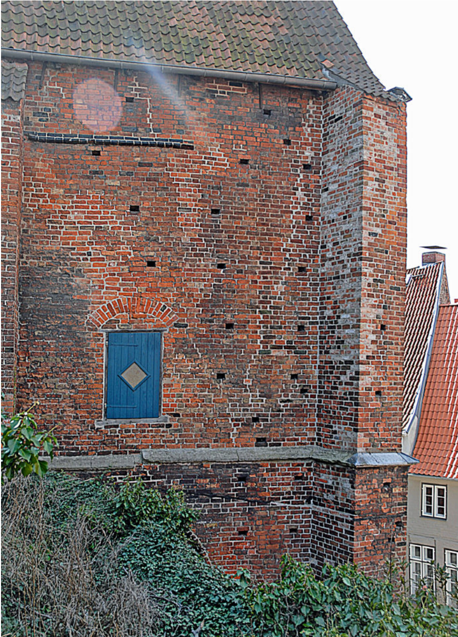
Abb. 18: Mauerwerksrisse und Reparaturen an der Nordwand.
