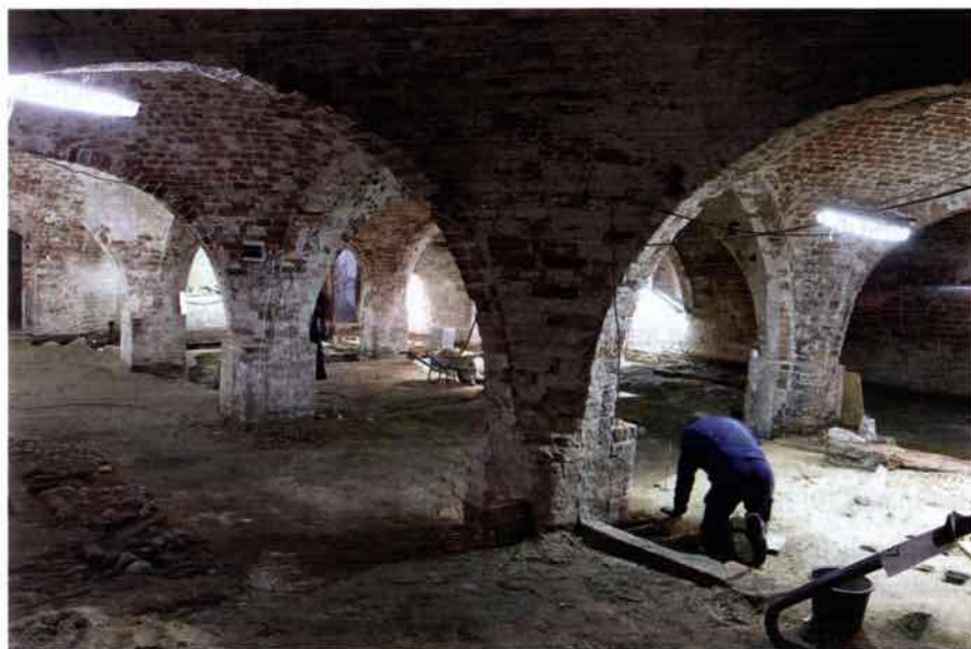
Abb. 16: Kleine Burgstraße 22 (Kranenkonvent). Blick in den Gewölbekeller nach Ausbau der Trennwände (v. SO).
