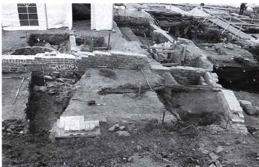
Abb. 11: Grabung „Beckergrube/Ellerbrook“. Durch Setzung des Untergrundes stark zur Blockmitte abgesackte Glinntmauer zwischen den Grundstücken Beckergrube 50 und 52, in Teilbereichen auch breite Rissfugen.
